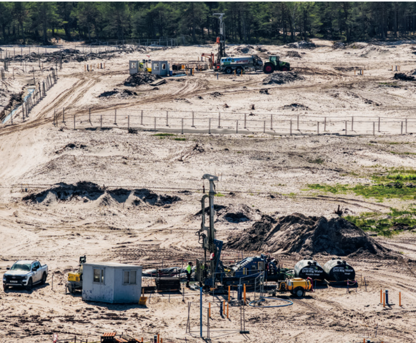
La première centrale devrait être pleinement opérationnelle en 2038. Les premières études géotechniques avancées se sont achevées en 2025, d'autres études sont en cours. (Photo: PEJ)
