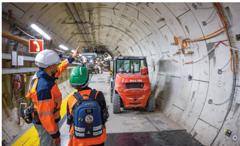
L'une des galeries d'expérimentation du laboratoire souterrain, où les principaux processus du stockage géologique profond sont étudiés dans des conditions représentatives. (Photo: Andra)
