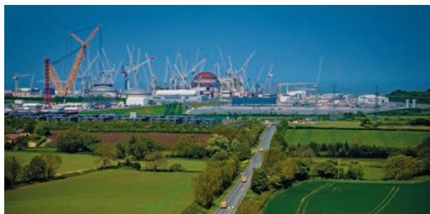
Das Kernkraftwerksprojekt Hinkley Point C zeigt die Notwendigkeit auf, den britischen Regulierungsrahmen für die Kernenergie grundlegend zu reformieren. (Foto: EDF Energy)
