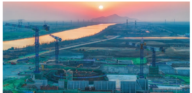
Der Bau von Xuwei-1 in der Stadt Lianyungang (Provinz Jiangsu) beginnt offiziell am 16. Januar 2026. (Foto: CNNC via CENN)
