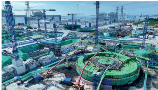
Coulage du premier béton de la tranche Zhangzhou 4 du type Hualong-One. (Photo: Copie d'écran d'une vidéo de cnnpn.cn, centrale nucléaire de Zhangzhou)
