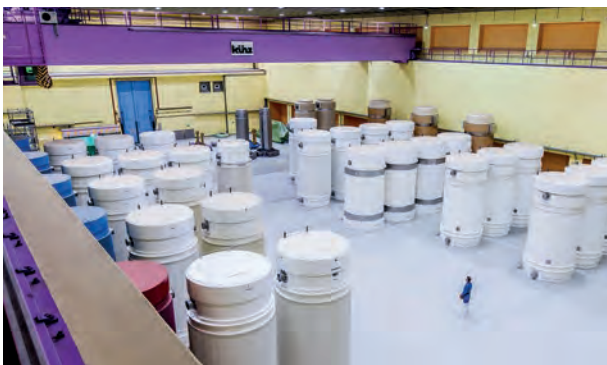
Coup d'œil dans la halle de stockage des conteneurs à Zwilag, Würenlingen. Cette halle permet de stocker les déchets vitrifiés hautement radioactifs issus des installations de retraitement et les assemblages combustibles usés provenant des centrales nucléaires suisses. (Photo: Zwilag)
