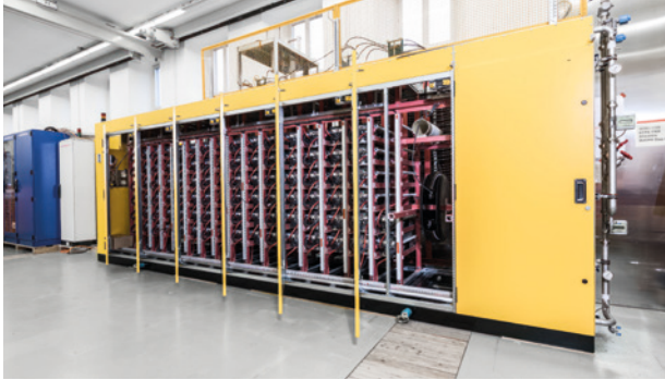
Une des alimentations principales en courant continu haute tension (main high voltage DC power supplies) qu'Ampegon a fabriquées pour le réacteur expérimental thermonucléaire international Iter, dans le sud de la France. (Photo: Ampegon Power Electronics)
